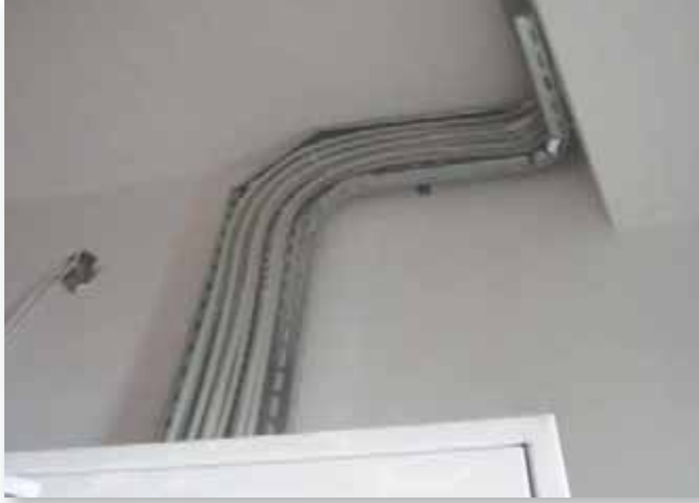
Kablolar bina içerisinde tek bir kanala döşenirler.
